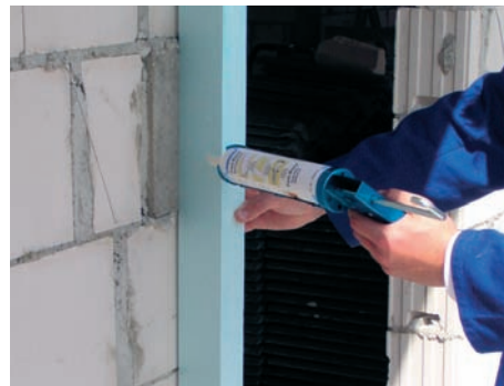
Incollaggio di un elemento di plastica espansa rigida a una parete di Gasbeton
