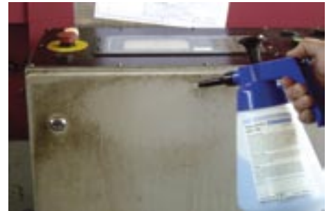
Reinigen von Verkleidungen, auch an Schaltanlagen Cleaning of cases, e.g. switchboard plants
